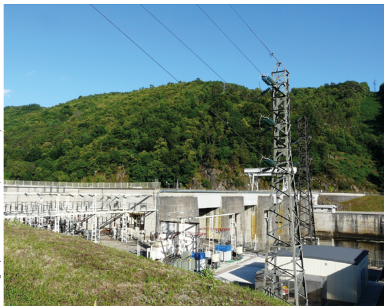
Le poste de transformation électrique du barrage d'Argentat (Corrèze, France).
