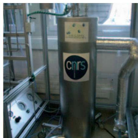
1. Réservoir d'hydrure de magnésium d'une capacité de 7m 3 d'hydrogène.
